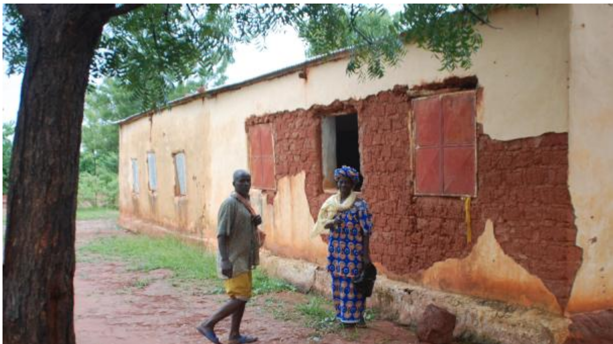
Die in Selbsthilfe erstellte Dorfschule von Pimperna ist in schlechtem Zustand; mehr und bessere Klassenräume und Lehrkräfte stehen zuoberst auf der Prioritätenliste der Gemeinde.
