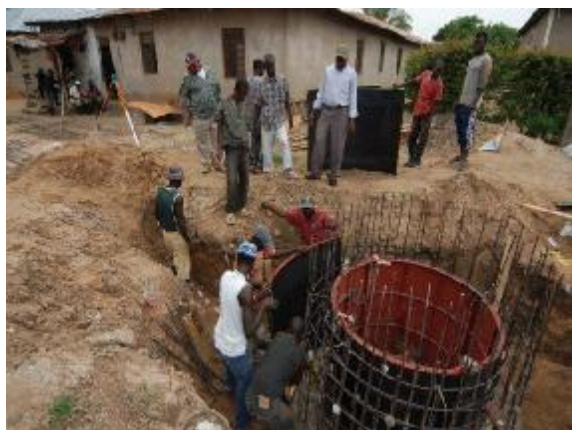
Die Schweiz unterstützt die städtische Wasserbehörde von Dodoma bei Erweiterung ihres Entsorgungsnetzes in den Quartieren.
