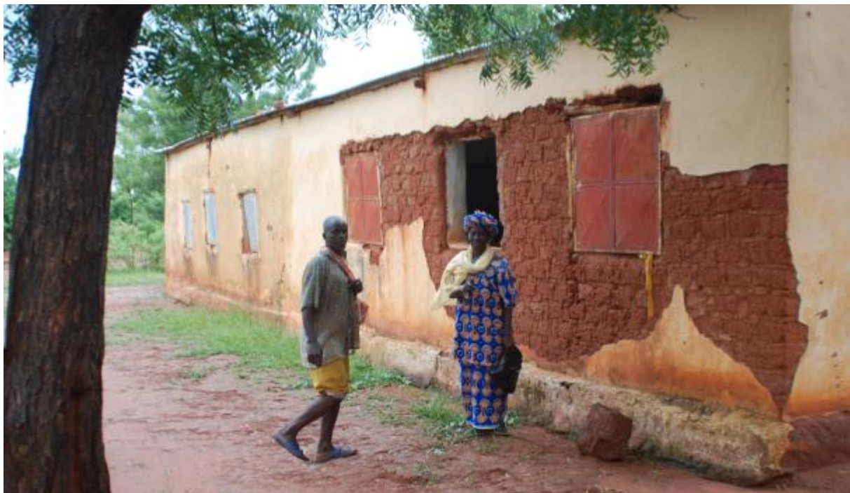
L'école du village de Pimperna construite par les habitants est en mauvais état ; améliorer le nombre et la qualité des salles de classe et du personnel enseignant figure en tête des priorités de la commune.
